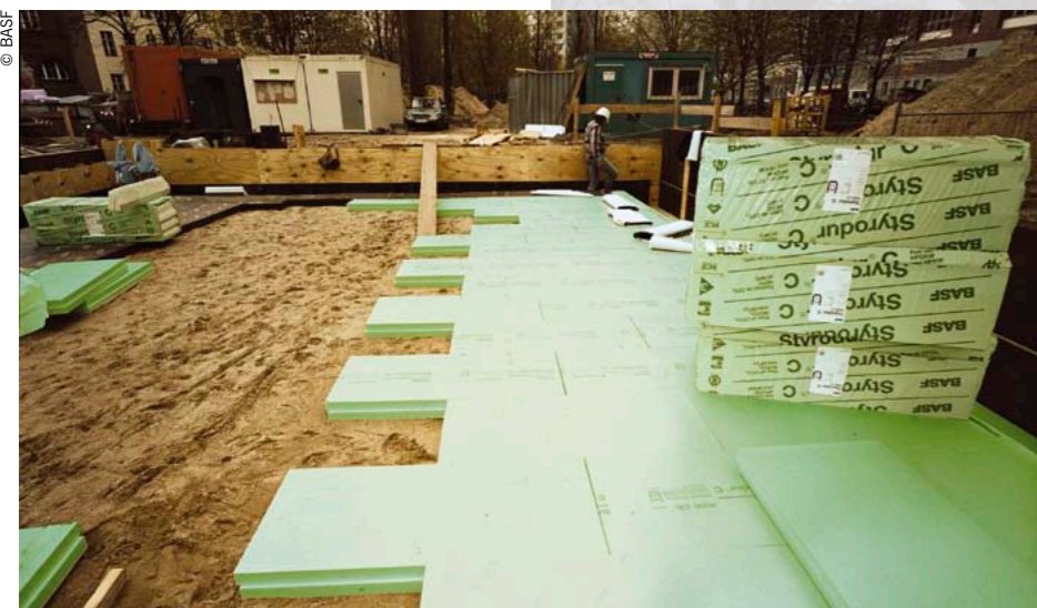
Fot. 6 Docieplanie pod wybudowanie projektowanych posadzek piwnicznych. Po zakończeniu robót ziemnych na zniwelowanym gruncie układane są termoizolacyjne płyty XPS.
